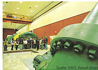
Kraftwerk Grimsel 2, Blick in die Kraftwerkskaverne
