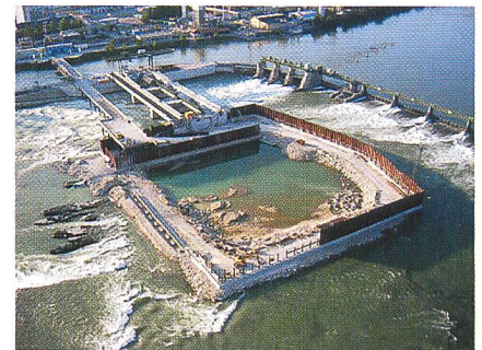
Baugrubenumschliessung der zweiten Baugrube wurde im November 2005 abgeschlossen. Die Baugrubenumschliessung sowie die neue Rampe für die zweite Baugrube sind fertig gestellt. Nach Abschluss der Injektionsarbeiten konnte mit dem Ausbruch des Muschelkalkfelsens noch im Dezember begonnen werden. Danach kann die Bodenplatte für die nächsten drei Wehröffnungen vorbereitet werden (Bilder: energiesdienst).
