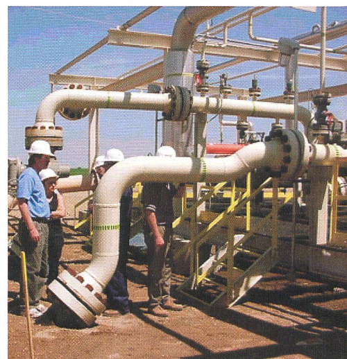
Pipeline CO 2 entrant à Weyburn.
