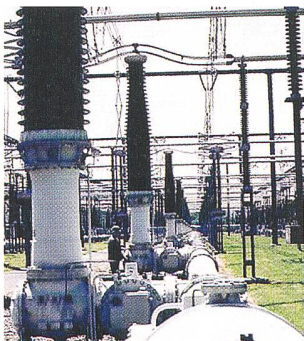
Les gaz fluorés sont utilisés dans des systèmes de transmission électriques (poste de couplage/foto EGL).
