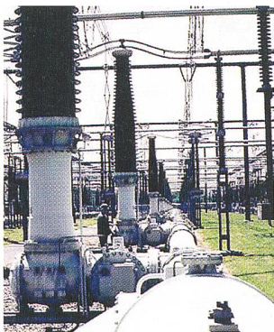
Les gaz fluorés sont utilisés dans des systèmes de transmission électriques (poste de couplage/foto EGL).
