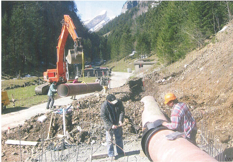
Bild 2 Teuerstes Projektelement: die neue Druckleitung
