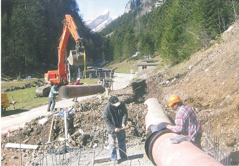
Bild 2 Teuerstes Projektelement: die neue Druckleitung
