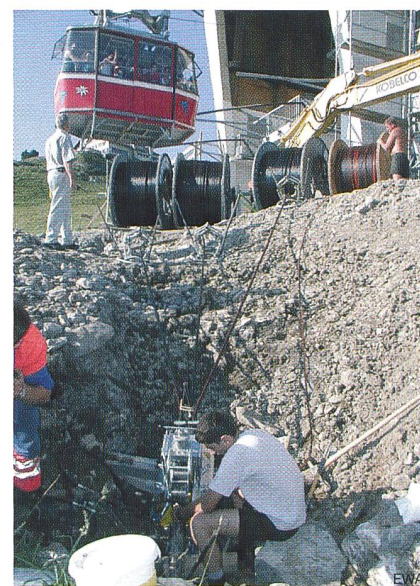
Bild 4 Die Kosten für das Verlegen der Kabel wurden von den Berggasthäusern getragen.
