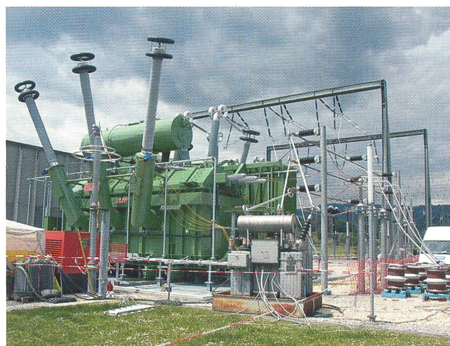
Bild 1 Netzkupplungstransformator mit Längs- und Querregelung in Bassecourt, hier bei der Hochspannungsprüfung nach der Montage
