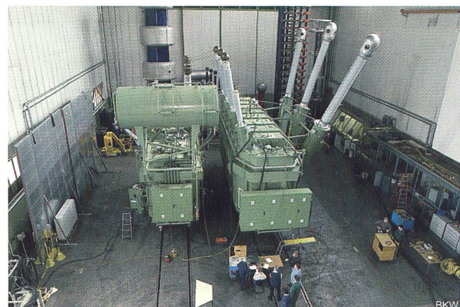
Bild 6 Prüfung der Transformatorgruppe im Werk (ohne Kühler), links der Reguliertransformator, rechts der Haupttransformator
