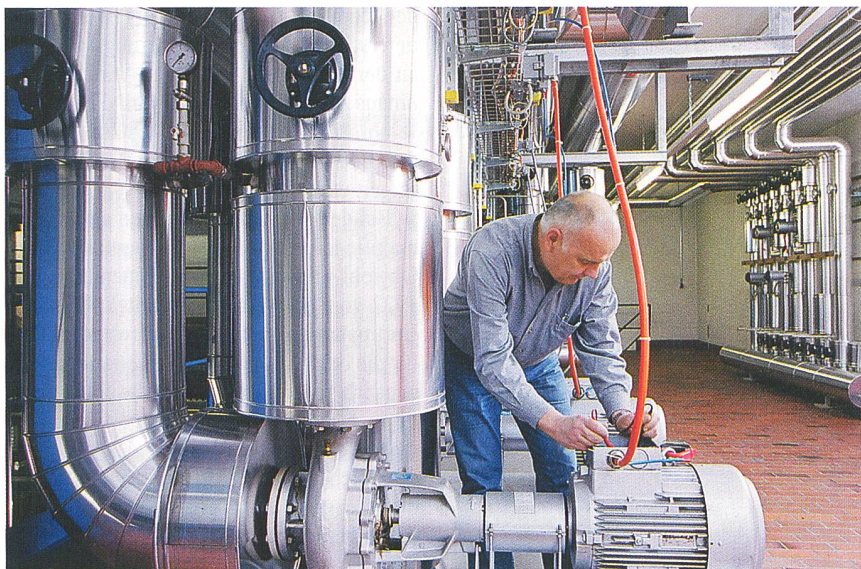
Messungen an einer Umwälzpumpe (Bild: ekz).
