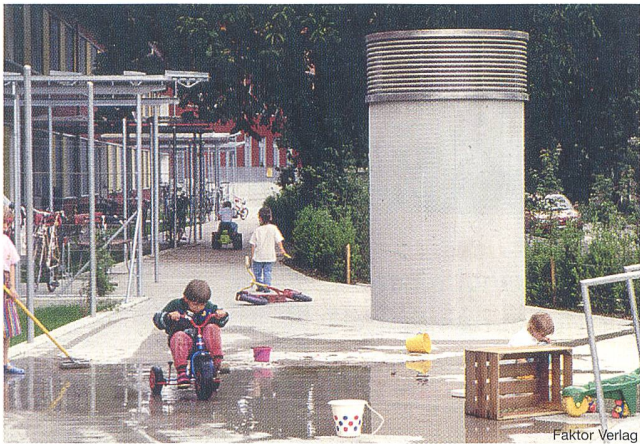
Bild 3 Beispiel für eine Aussenluft-Ansaugöffnung
