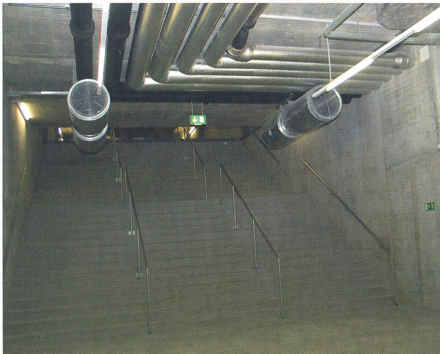
Erste Priorität im Notfallszenario hat die Beleuchtung der Fluchtwege. Diese sind ohnehin permanent über Batterie versorgt; ein Ausfall ist nach menschlichem Ermessen praktisch auszuschliessen.
