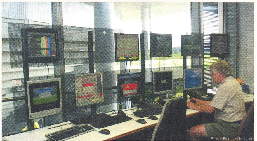
In der Kommandozone der MIB AG laufen alle Fäden des Wankdorf-Centers zusammen. Es besteht ein 24-Stunden-Pikettdienst; die Alarmierung erfolgt automatisch auf Pager. Foto: Electrosuisse/hm
