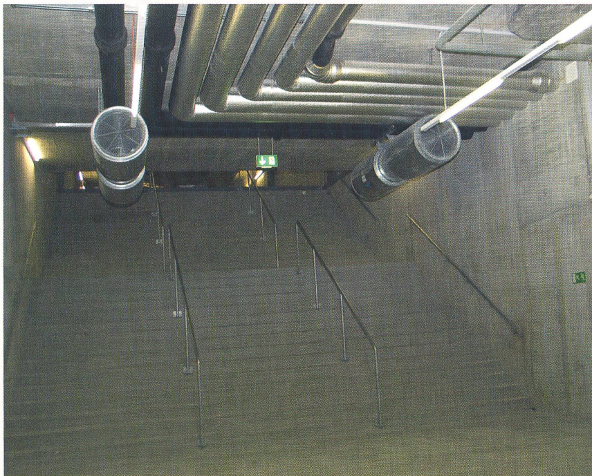
Erste Priorität im Notfallszenario hat die Beleuchtung der Fluchtwege. Diese sind ohnehin permanent über Batterie versorgt; ein Ausfall ist nach menschlichem Ermessen praktisch auszuschliessen.
