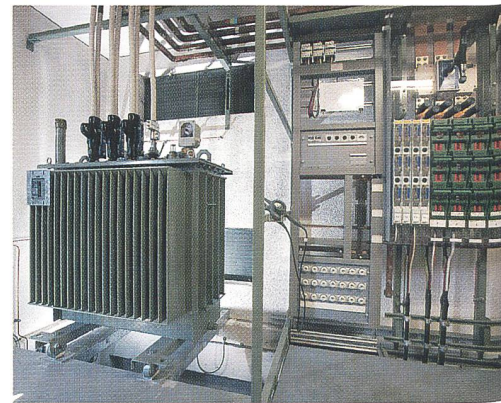
Strom aus der Trafostation Zürcherstrasse in Birmensdorf
