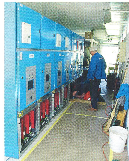
Inbetriebsetzung der Schaltanlage.
