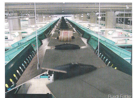
Die Gepäckabfertigung am Flughafen Kloten darf nicht stillstehen. Dazu braucht es aber keine teuren, proprietären Systeme, es reichen standardisierte SPS-Steuerungen.
