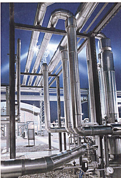
Bild 3 Oberirdisches Rohrleitungssystem der Gasspeicheranlage in Huntorf (Bild EWE).
