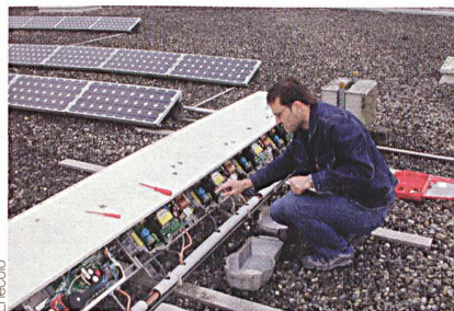
Ein aktuelles Forschungsprojekt untersucht die Betriebs- und Unterhaltskosten von FV-Anlagen.
