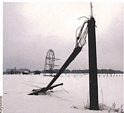
Figure 4 Des tours effondrées. Une tempête de neige accompagnée de vents violents ont récemment détruit des lignes électriques en Allemagne. Les normes de construction en vigueur n'excluent pas des ruines.
