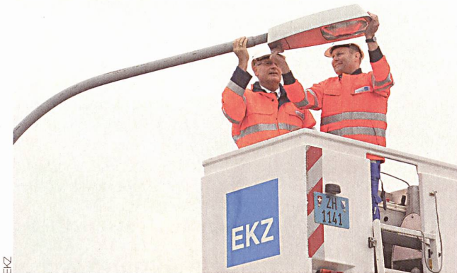
Mit neuer Strassenbeleuchtung Strom sparen.
