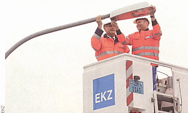
Mit neuer Strassenbeleuchtung Strom sparen.
