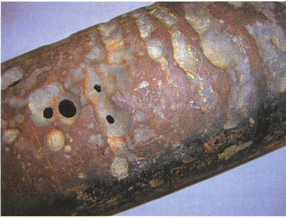
Bild 4 Korrosion durch Stromeinwirkung an einem duktilen Gussrohr.
