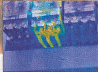
Wärme- und Sichtbild überblendet
