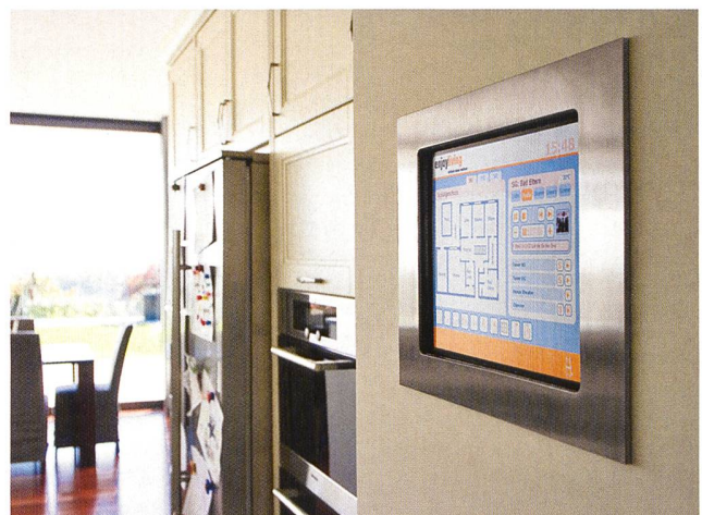
Bild 1 Gebäudeautomation für mehr Komfort und Sicherheit fängt nicht erst bei einem Zehnkilofranken teuren LCD-Touchpanel an.
