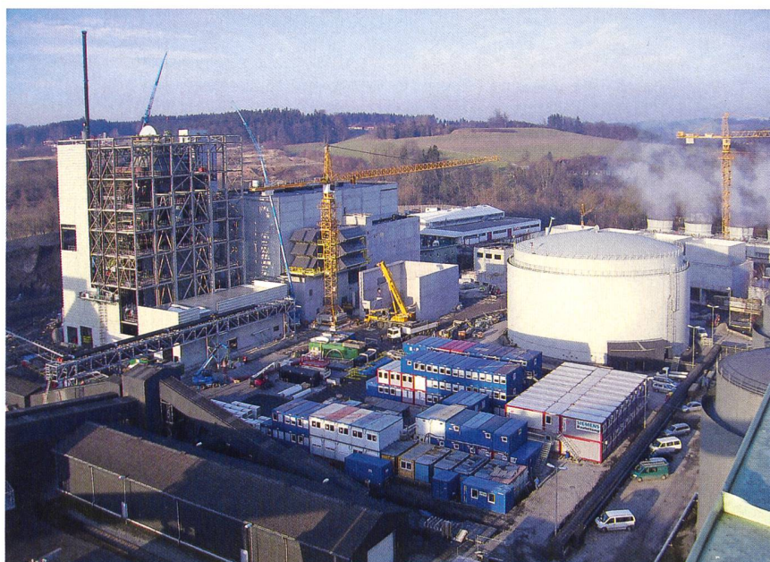
Construction de la centrale à cycle combiné (gaz et vapeur) à Timelkam (Autriche).
