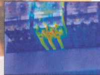
Wärme- und Sichtbild überblendet
