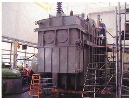
Gute Voraussetzungen für den Trafo-Vollservice: EKZ Service Center.
