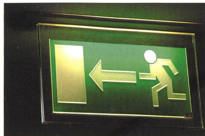
Bild 12 Sorgenkind in Wartung und Betriebskosten: Fluchtwegbeleuchtung.
