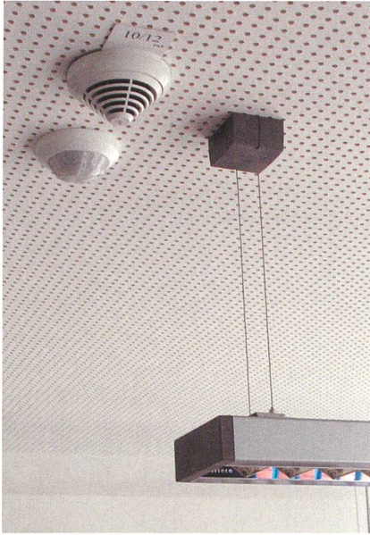
Bild 9 Jeder Raum verfügt über einen Bewegungssensor und einen Rauchmelder.
