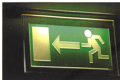
Bild 12 Sorgenkind in Wartung und Betriebskosten: Fluchtwegbeleuchtung.
