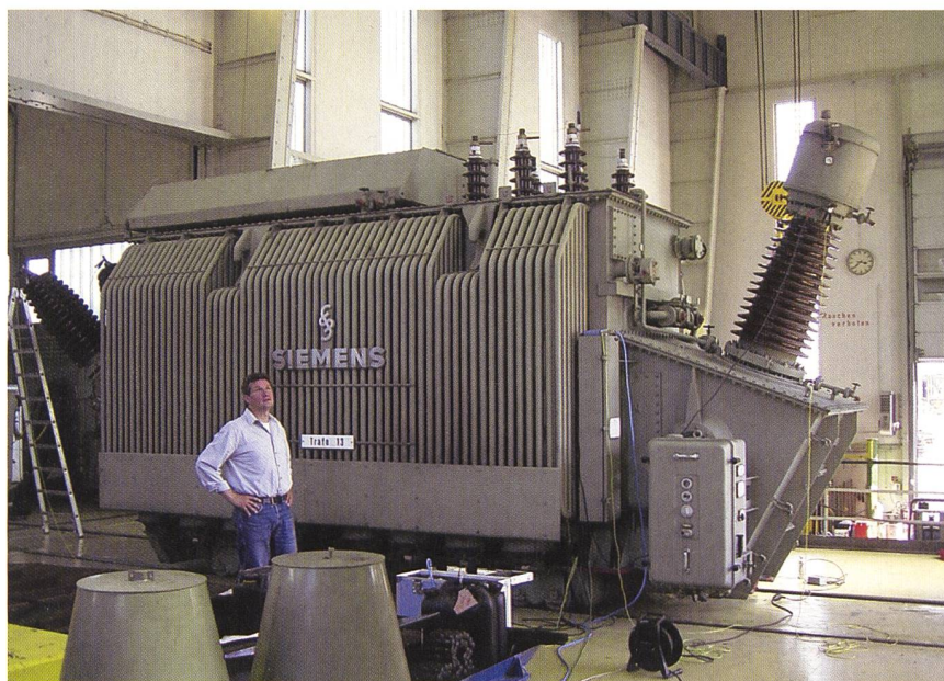
Bild 7 Transformator in der Werkstatt.
