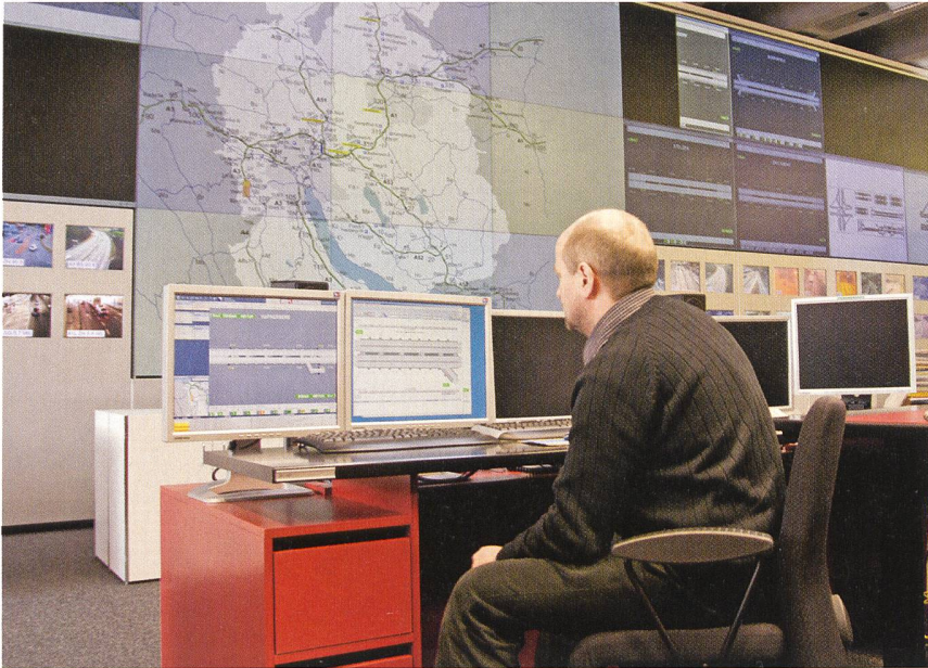
Bild 2 UeLS-Bedienstation in der Betriebsleitstelle Urdorf.
