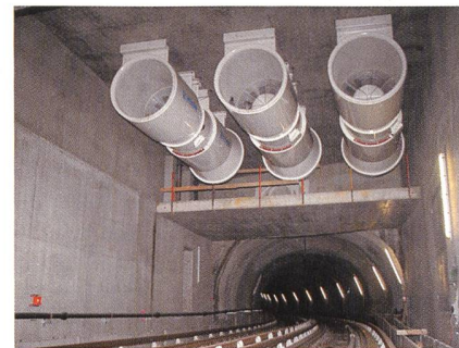
Le désenfumage du métro M2 à Lausanne.
