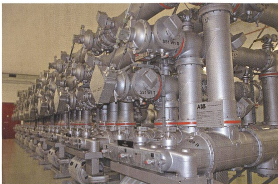
An der gasisolierten 150-kV-Schaltanlage des Unterwerks Zeughaus in Zürich wurden bei der Diagnose 90 Messungen durchgeführt.
