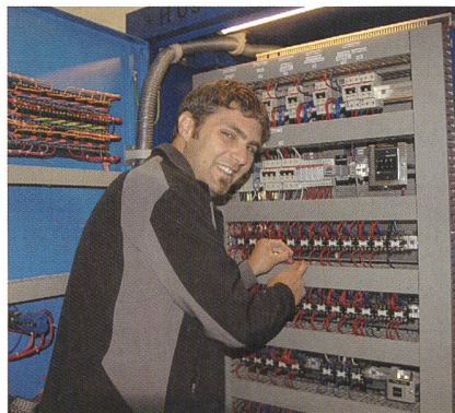
«Eine zustandsorientierte Instandhaltung ist uns wichtig», erklärt Daniel Köchli, Anlageverantwortlicher beim EWZ.
