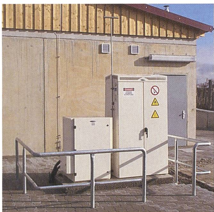
Bild 7 Brennstoffzellensystem im Freien installiert.
