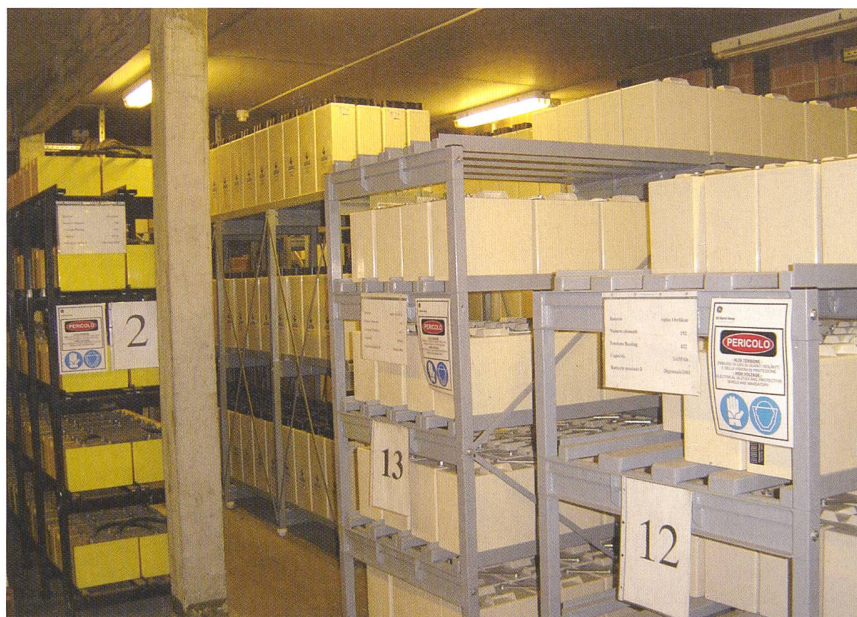
Bild 4 Akkumulatoren-Raum in einem Industriebetrieb.
