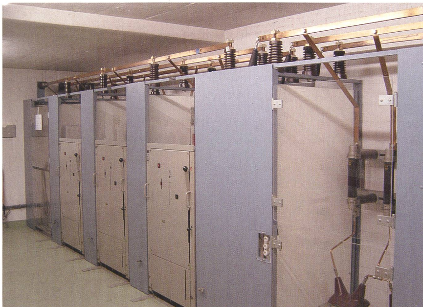
Bild 5 Trafostation in einem Industriebetrieb.
