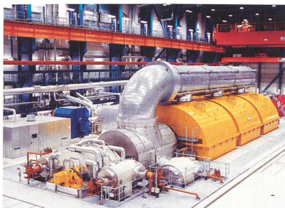
Dieser Generator liefert 2000 MVA – und ist auch nur eine rotierende Maschine.
