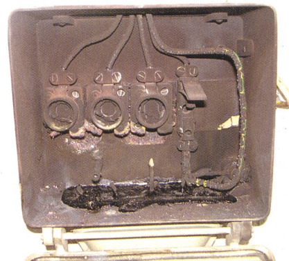
Figure 2 Le monteur-électricien a touché le conducteur polaire et la carcasse métallique avec le tournevis non isolé.
