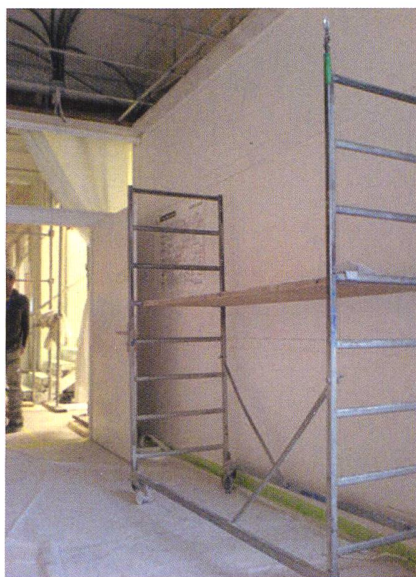
Figure 1 Les profils de plafond sur lesquels le monteur travaillait depuis l'échafaudage roulant se trouvaient sous tension.
