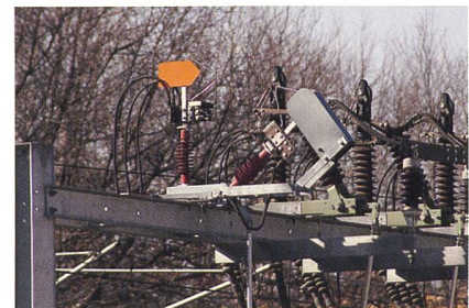
Erdungsschalter im Sternpunkt. Disjoncteur shunt en neutre.
