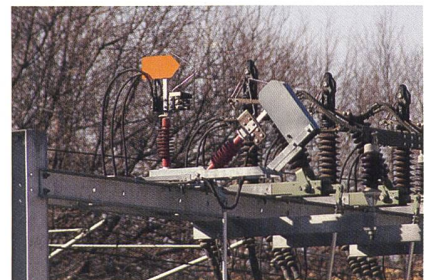
Erdungsschalter im Sternpunkt. Disjoncteur shunt en neutre.
