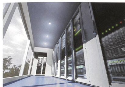
Komplettlösungen von Rittal für energieeffiziente, sichere und hochverfügbare IT-Infrastrukturen.
