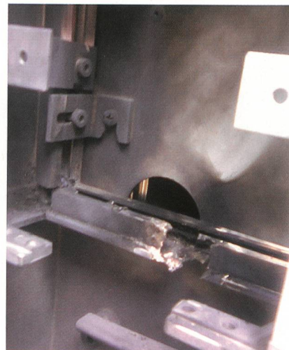
Bild 6 Der Erdschluss brannte ein grosses Loch in das Rahmenprofil und entzweite den Leiter L3.
