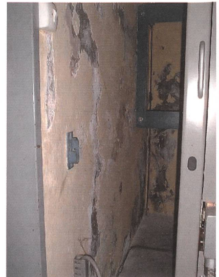
Bild 4 Wandschaden durch Feuchtigkeit im Baukörper einer Trafostation.
