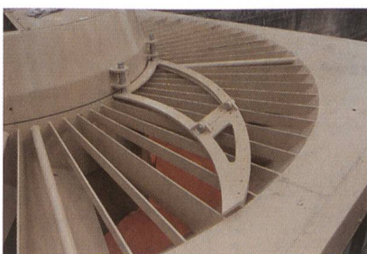
Grobrechen mit Rechenreiniger.
