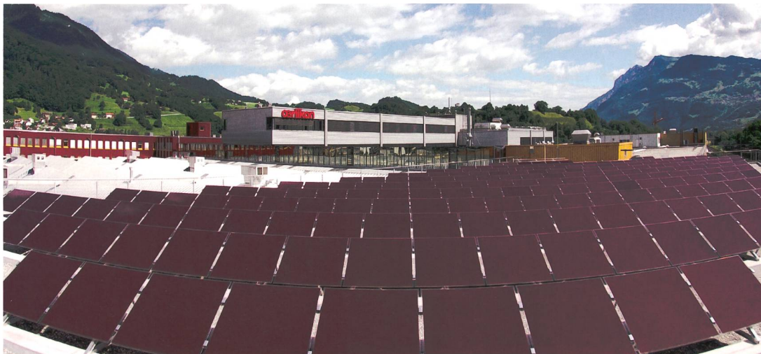
Figure 5 Microcentrale de 16 kW p (puissance maximale dans des conditions standard) installée sur le toit du bâtiment d'Oerlikon Solar à Trübbach SG. Elle est constituée de modules de silicium en couche mince de production « maison ».
