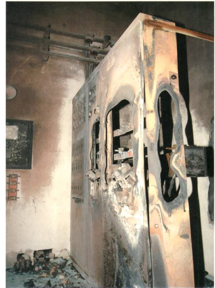
Bild 4 Beschädigte Schaltgeräte-kombination durch Kurzschluss.
