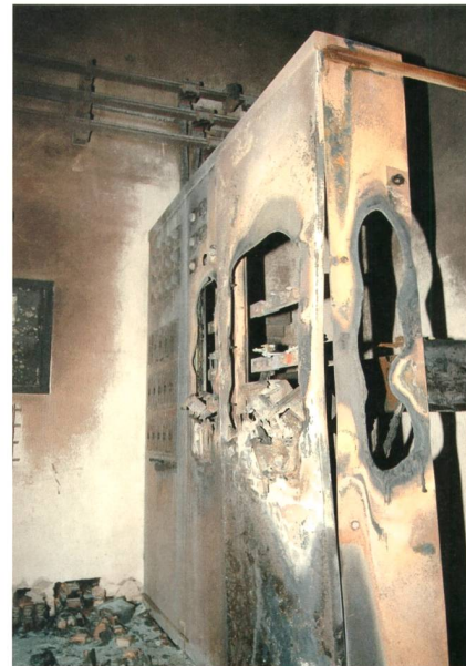
Illustration 4 Ensembles d'appareillage endommagés par un court-circuit.
