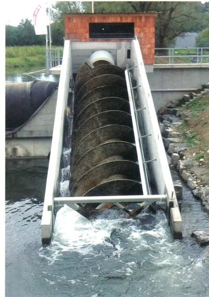
Mit einer Nennleistung von 100 kW liefert die Schraube Strom für rund 100 Haushalte.
