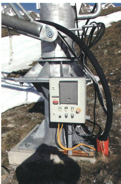
Illustration 3 Câble non protégé vers l'armoire de distribution. Non conforme à la norme !
