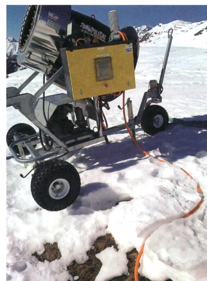
Bild 4 Zuleitung zu Schneekanone. Nicht normenkonform!
