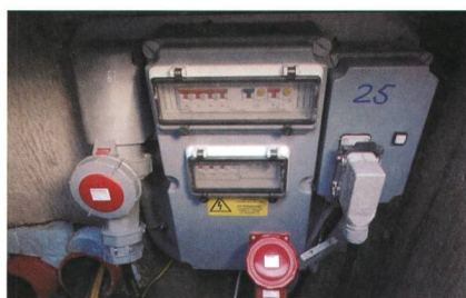
Illustration 1 Armoire de distribution souterraine.
