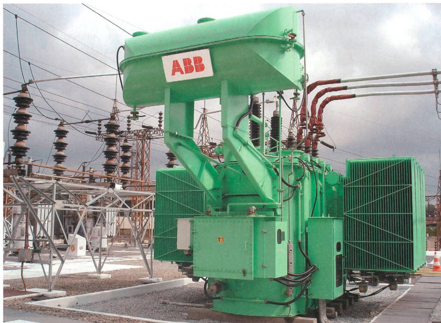
Figure 3 Transformateur ABB de 25 MVA, 138 kV, rempli avec l'huile ester naturel Biotemp.
