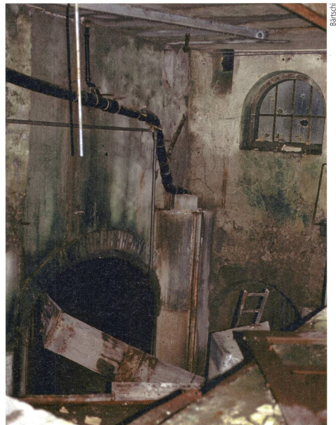
Bild 6 Innenansicht des 1859–1863 erbauten Wasserschlosses für das Pumpspeicherwerk Schmid Gattikon vor dem Abbruch (Aufnahme vom 13. März 1983).
