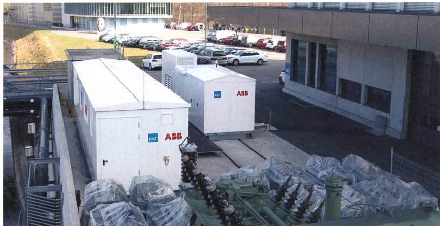
Bild 2 Batteriespeicher bei den EKZ in Dietikon. Links ist der Speichercontainer, rechts befindet sich die Leistungselektronik.
