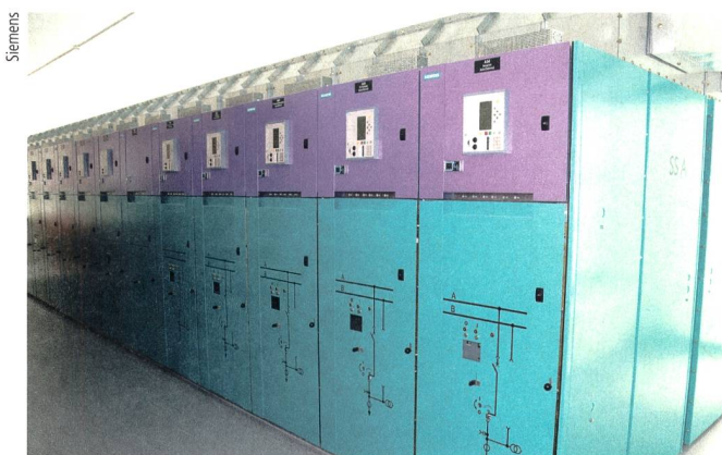
Bild 5 Luftisolierte Siemens-Schaltanlage NXAIR in Duplex-Ausführung, in Betrieb im UW Wil.
