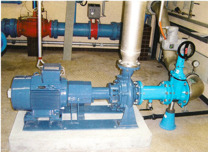
Figure 2 Pompe inversée sur l'eau potable de la ville de Morges (débit : 76 l/s, chute : 43 m, puissance électrique : 23 kW, production électrique : 125 000 kWh/an, mise en service en 2011).
