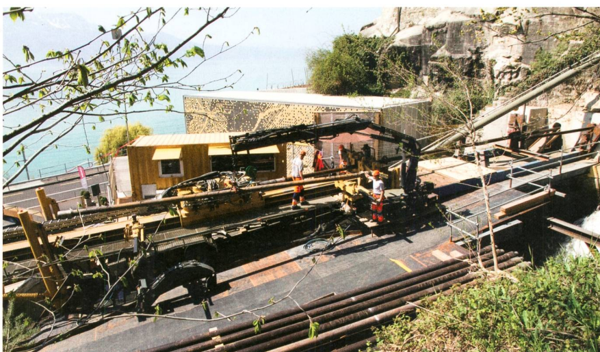
Figure 6 Chantier du forage dirigé de la réhabilitation du site de Rivaz/VD, au bord du lac Léman (débit : 500 l/s, chute : 178 m, puissance électrique : 730 kW, mise en service prévue en 2014).
