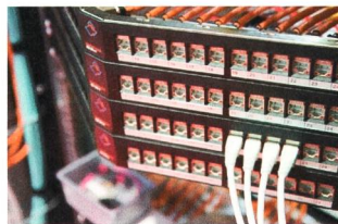
Solutions pour les bureaux en cuivre et en fibres optiques
