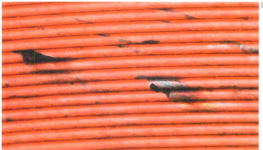
Bild 1 Anfangsstadium eines Wicklungsdefekts, verursacht durch potenziell korrosivem Schwefel im Isolieröl.[1]
