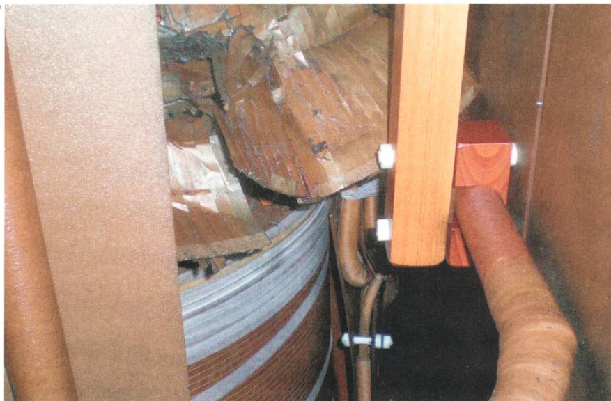
Bild 3 Transformator mit deutlichen Kupfersulfidablagerungen auf der Feststoffisolation.
