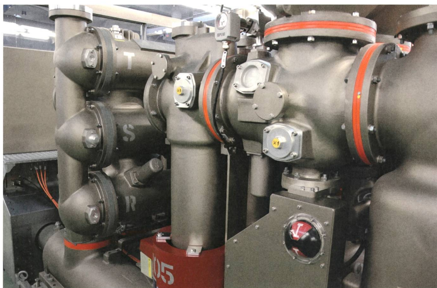
Premiere einer Schaltanlage mit klimafreundlichem Gasgemisch.
