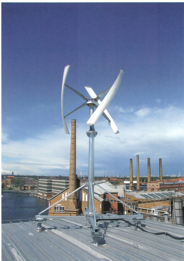
Kleinwindanlage für Tests auf dem Gelände der HTW Berlin.
