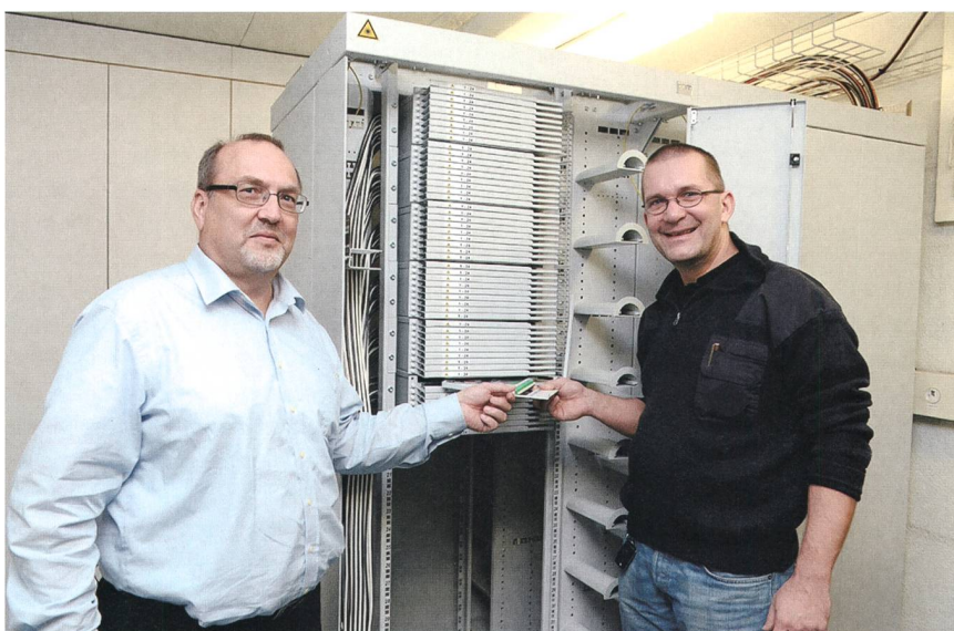
Markus Schlatter (CEO) und Patrick Amstutz (Technischer Bauleiter) vor einem Carma ODF von Connect Com AG.
