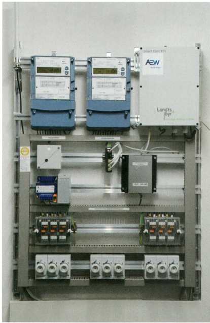
Bild 2 Überwachung und Steuerung der Transformatorenstation Niederwil mit paralleler Energieabrechnung.
